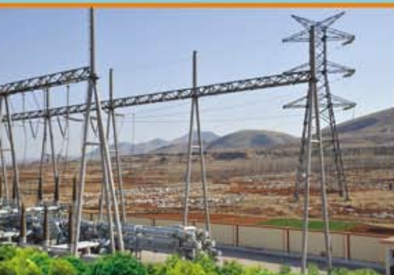
220千伏云蒙站一角
